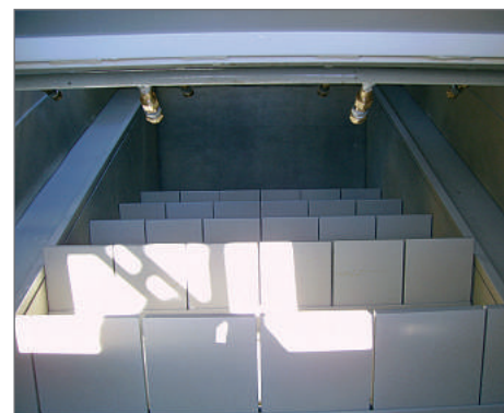
Рис.1 Бункеры с системой форсунок высокого давления
