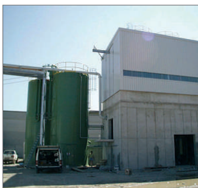
Рис.5 Очистной реактор и цех прессования шлама
